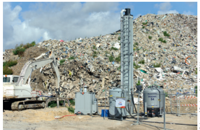
Station de traitement des eaux présente sur un site pollué (Val-de-Marne).
